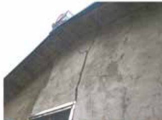
파손된 피보험자 주택 내력벽 모습
